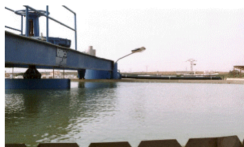
Sistemas de depuración de aguas residuales
