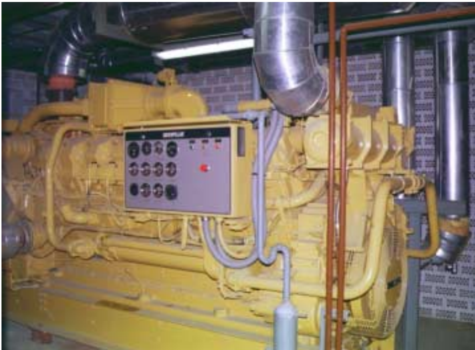
Motor Diesel de gas natural como máquina de cogeneración
