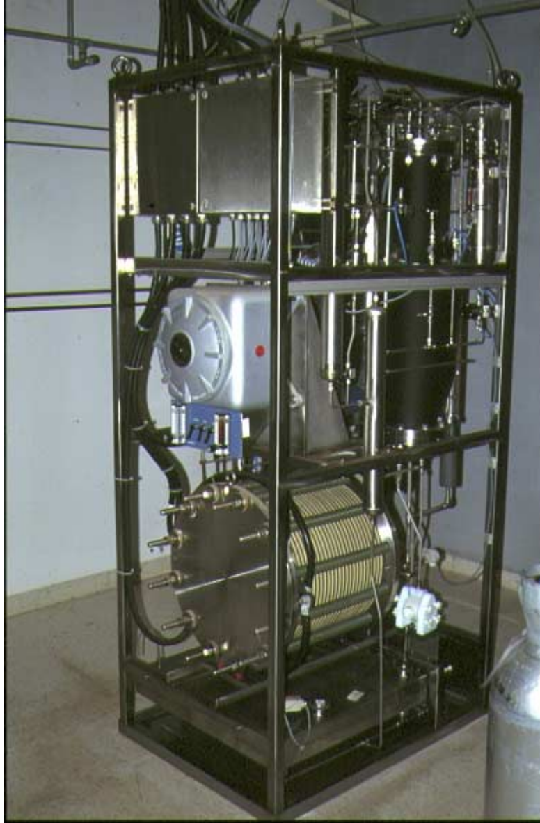
Electrolizador donde se produce hidrógeno a partir de energía solar fotovoltaica
