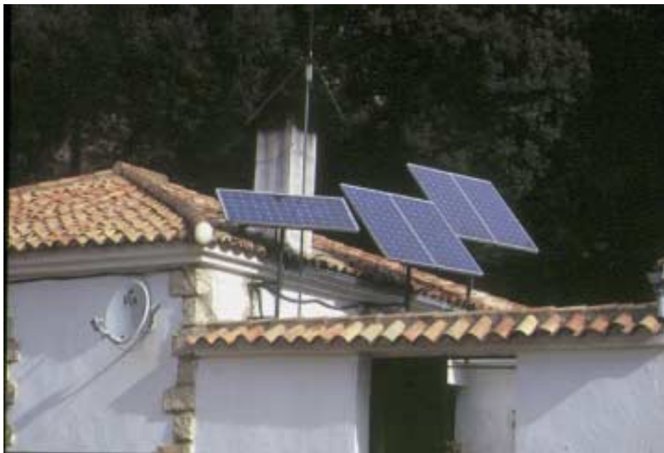
Instalación Fotovoltaica en el Parque Natural de Cazorla, Segura y las Villas
